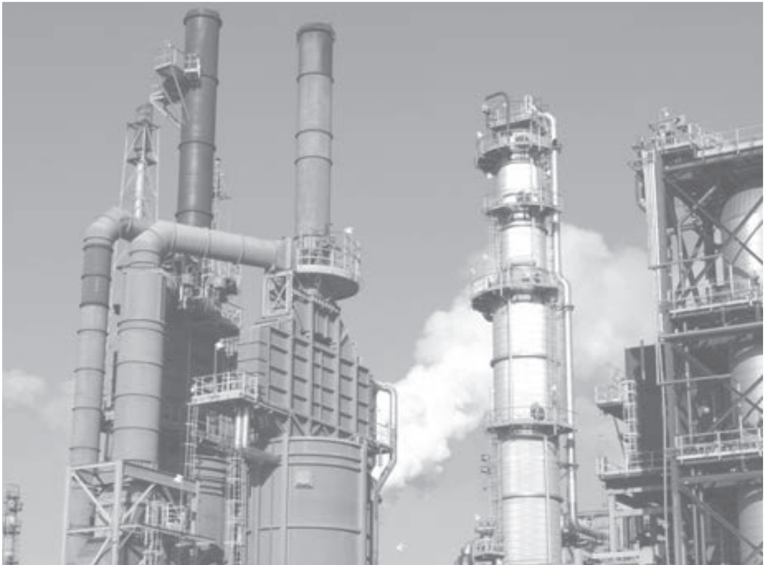
Figura 3.1 Torres de destilación.
